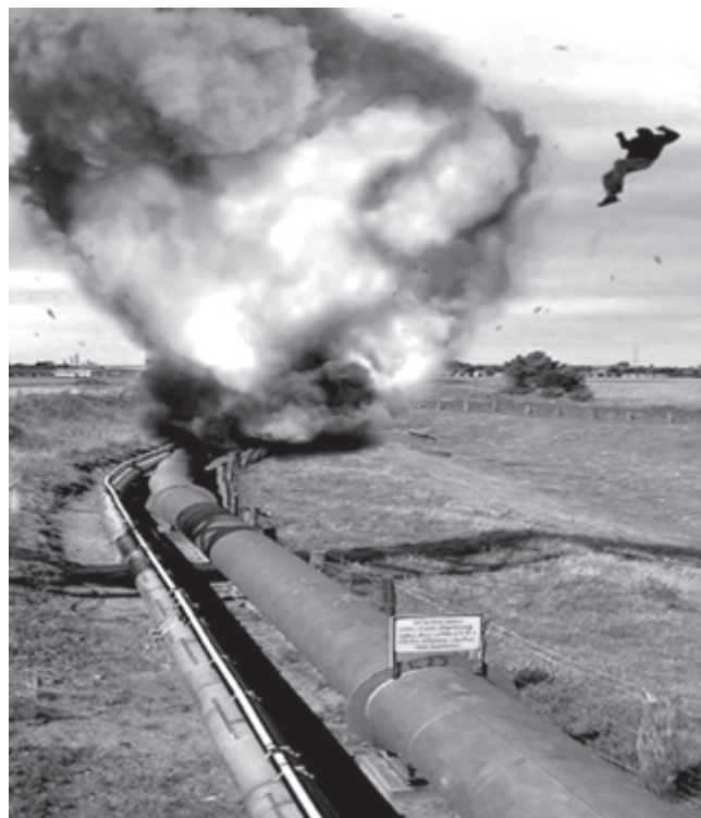
Рис. 3. Разрыв транспортного трубопровода
